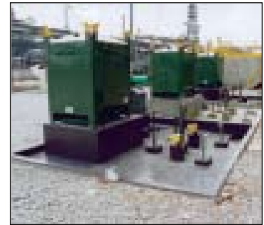
BACS DE RETENTION
