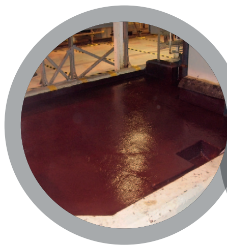
Cuves de rétention de produits chimiques
